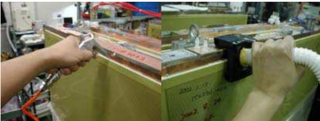
Fig. 4.33: リーク箇所を見つける2つの方法 (左が加圧法、右が減圧法)
