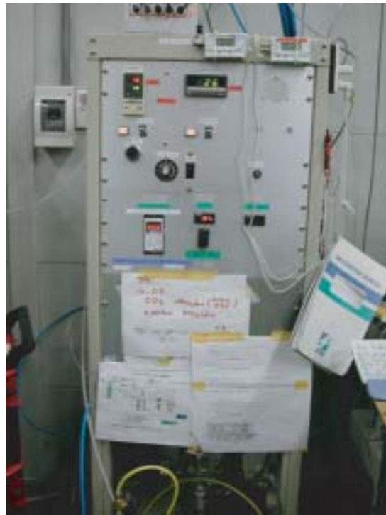
Fig. 4.26: ガス供給システム
