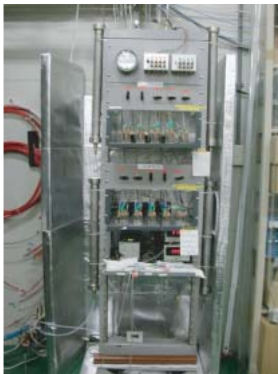
Fig. 4.27: ガス分配用ラック
