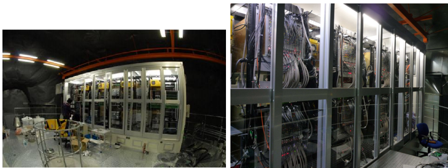
図 2.9: (左)ATM 側から見たエレクトロニクスハットと (右)FADC 側から見たエレクトロニクスハット
